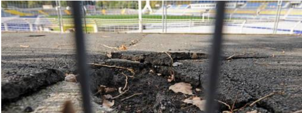
Das Jenaer Ernst-Abbe-Sportfeld ist sanierungsbedürftig. Foto: Tino Zippel
